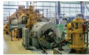
揚水発電機の温度・歪モニタ
